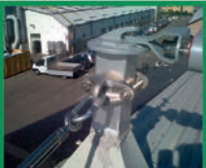
Sistemi di Sicurezza
