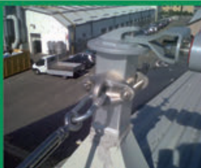
Sistemi di Sicurezza
